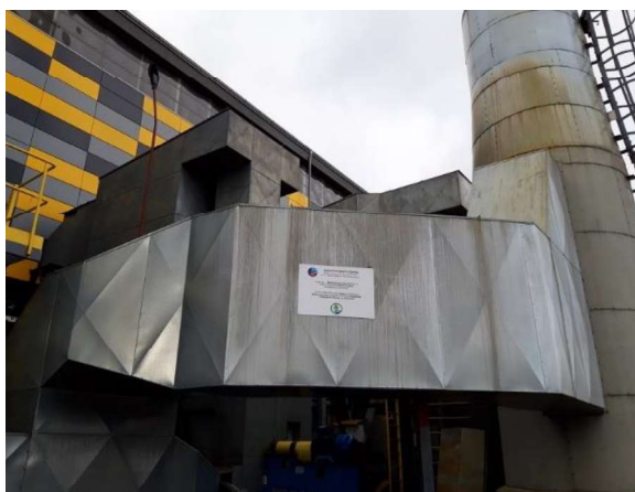
Rysunek 5. Modernizacja kotła WLM5 wraz z instalacją odpylania spalin w Ciepłowni Centralnej oraz rozbudowa i modernizacja systemu ciepłowniczego miasta Bolesławiec, ZEC Bolesławiec
